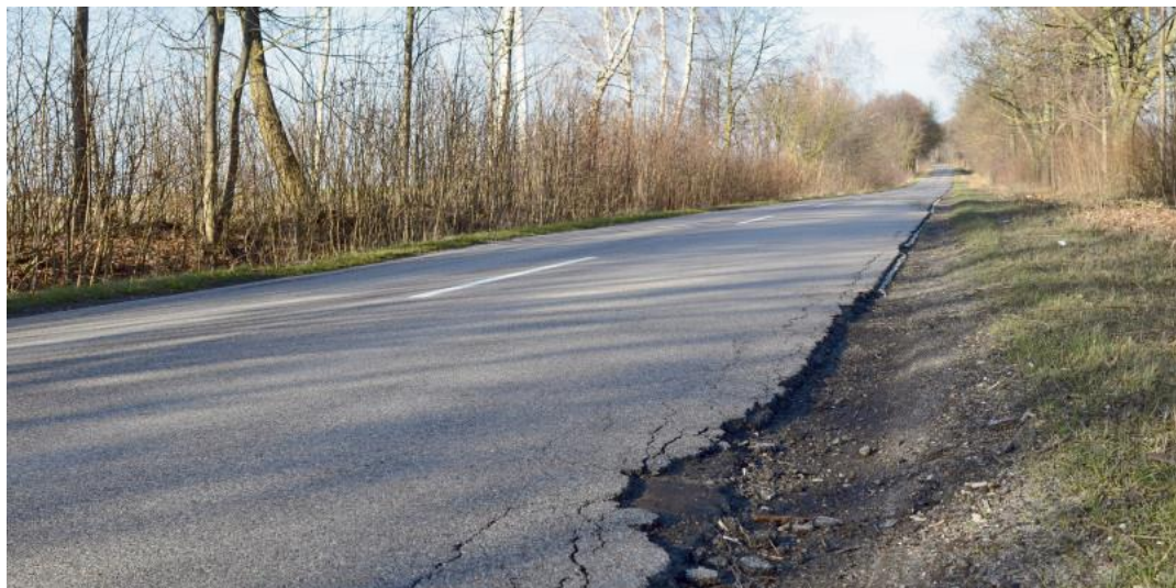
Rys. 31. Pobocze niejednorolite wskutek zniszczonej jezdni [88]
