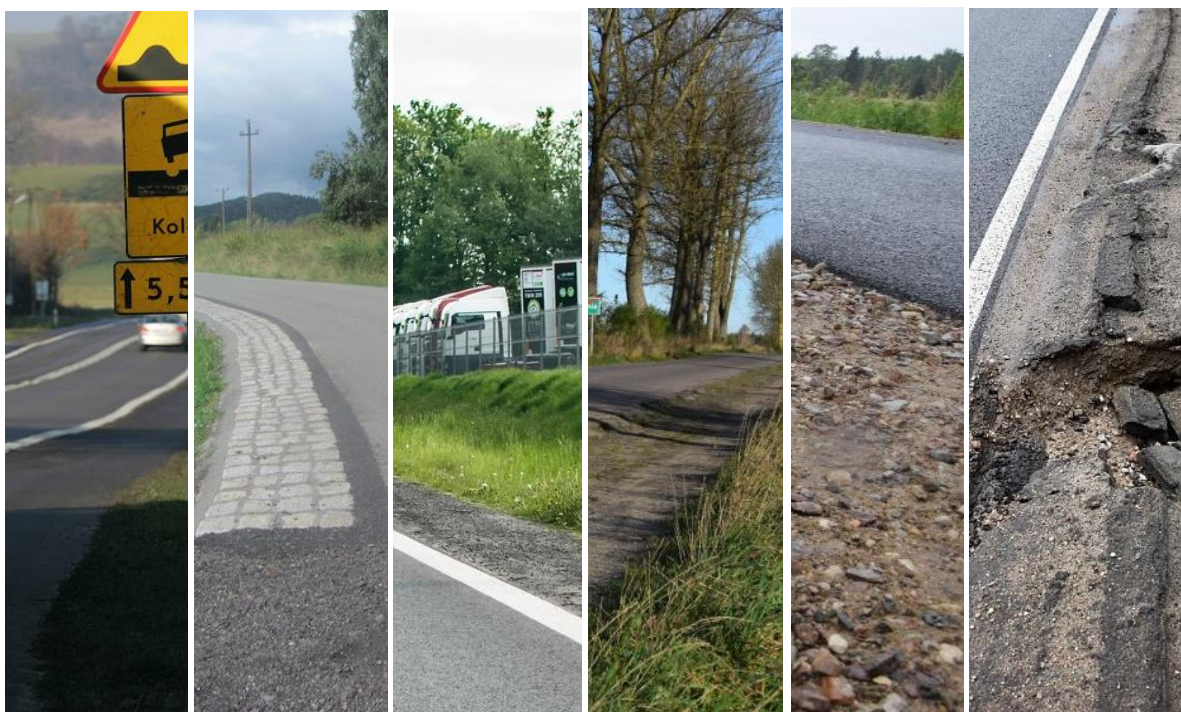
Rys. 12. W kolejności od lewej strony: pobocze asfaltowe [23], pobocze utwardzone kostką granitową [24], pobocze nieutwardzone [25], pobocze drogi gminnej [26], pobocze uszkodzone [27]
