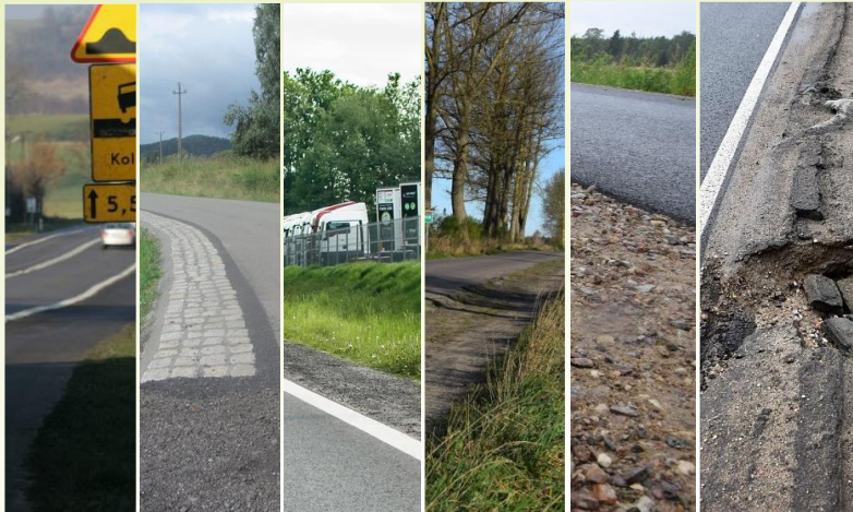
Pobocze: asfaltowe, utwardzone kostką granitową, nietwardzone, drogi gminnej, uszkodzone
